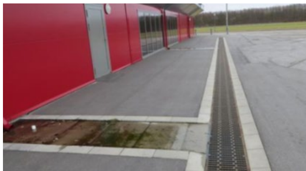
En etablert 'vullgrav' langs utsatte fasader. Vullgraven må ha et overløp. Foto: SBI-anvisning
