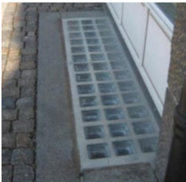
Lyskasser kan også lukkes til med glassten eller annet robust gjennomsiktig materiale. Som en midlertidig sikring kan den også overdekkes med en plate. Foto: Rørcenteranvisning 020
